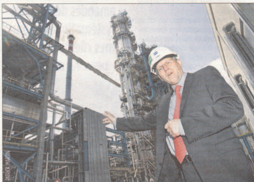
Frank Topin, posant ici devant l'unité du réacteur de craquage catalytique, assure que tout est étudié pour ménager le voisinage.
